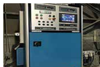
【多品種塗装製品向けに独自開発した塗料を塗装する自動塗装ロボット導入】
